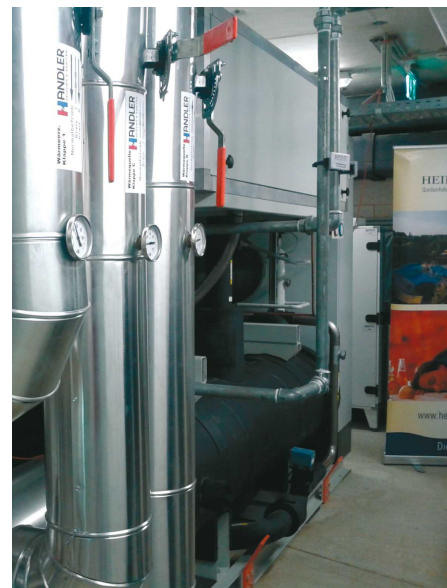
Die neue Energiezentrale in der Heiltherme
